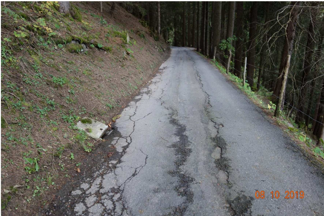
Typisches Bild mit der gerissenen Fahrbahnoberfläche, der steilen, abgefahrenen Böschung bergseitig und der steilen talseitigen Böschung mit teilweise fehlendem Bankett. Entwässerung mittels Einlaufschächte mit talseitigen Ausläufen.
