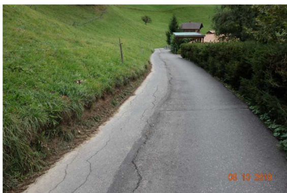
Abgefahrene, bergseitige Böschung infolge zu geringer Strassenbreite
